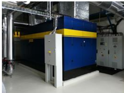
Foto č.2 Kogenerační jednotka, Hrádek n. N.
