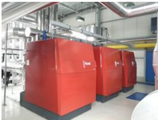
Foto č.1 Kondenzační kotle, Hrádek n. Nisou
